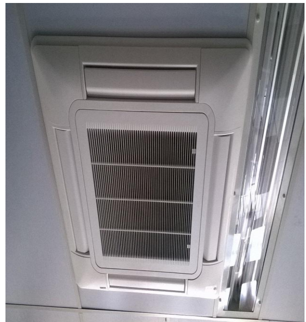
Sistema de Ar Condicionado
